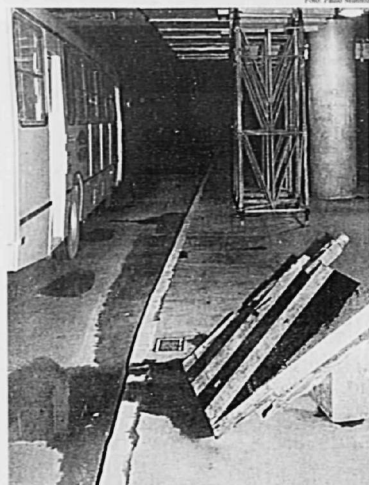
Rachaduras e infiltrações nas lajes da Estação da Lapa
